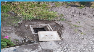
Mantenimiento Pozos a Tierra CR1
