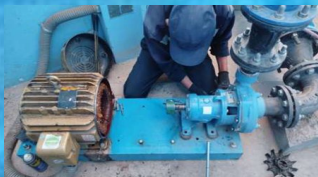
Mantenimiento de Motor Pichasani bajo
